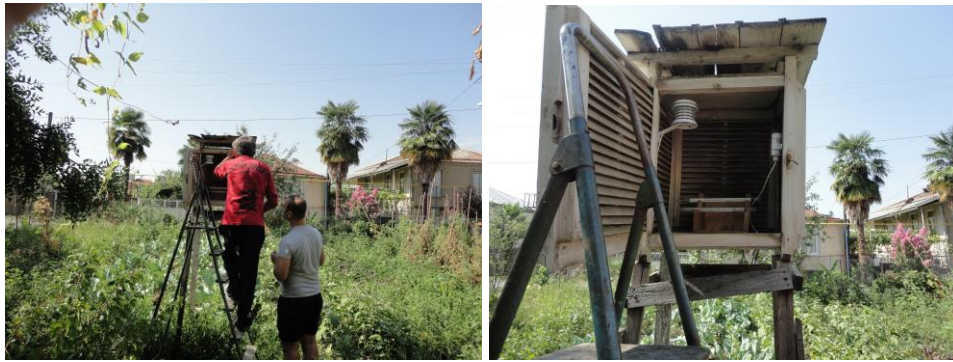
ნახ. 1 სარეჟიმო აპარატურის მონტაჟი ლაგოდეხის მეტეოსადგურზე
